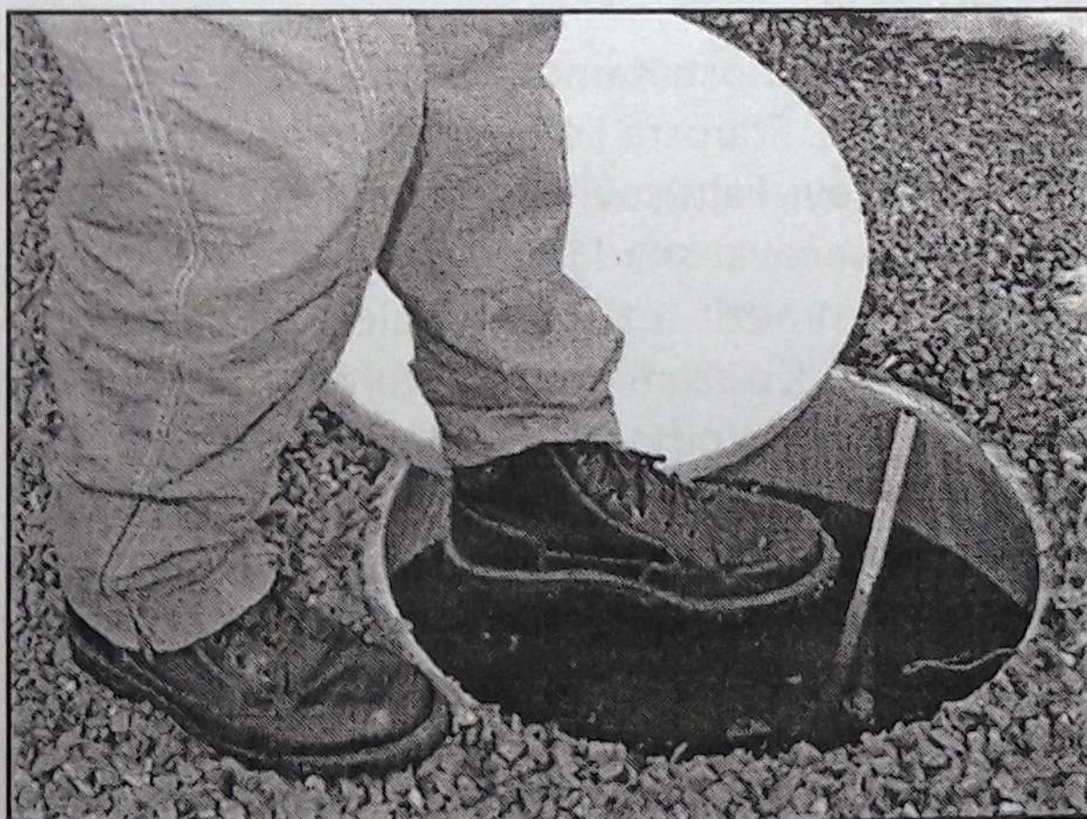
Tento kanál s volně položeným plastovým poklopem o průměru 60cm na Hradské ulici ohrožuje bezpečnost. Je dva metry hluboký a je v něm 1,8m vody.
