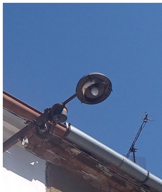
Obr. 18 Chybějící kryt svítidla
